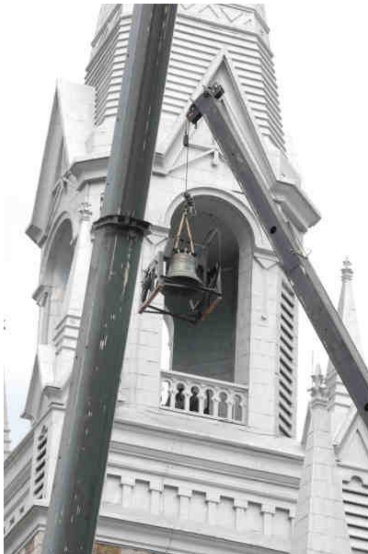
Église Sainte-Cécile du Bic (Photo Jacques Therriault) Phase I des travaux de réfection Début : 4 juillet 2011
